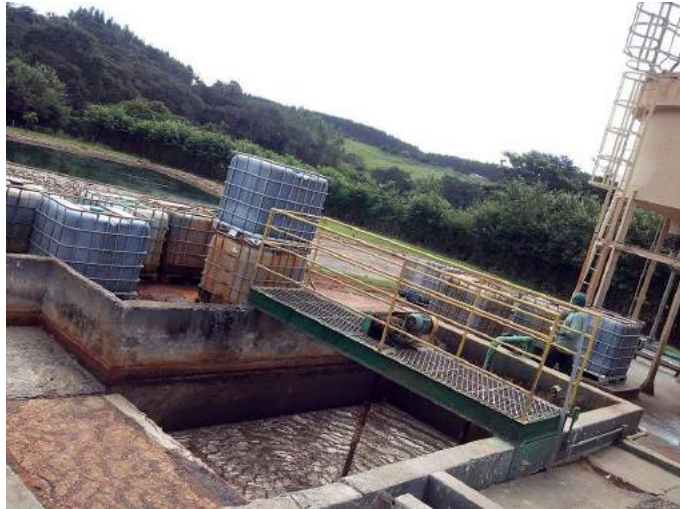
Figura 2- Unidade de tratamento (ETE).
